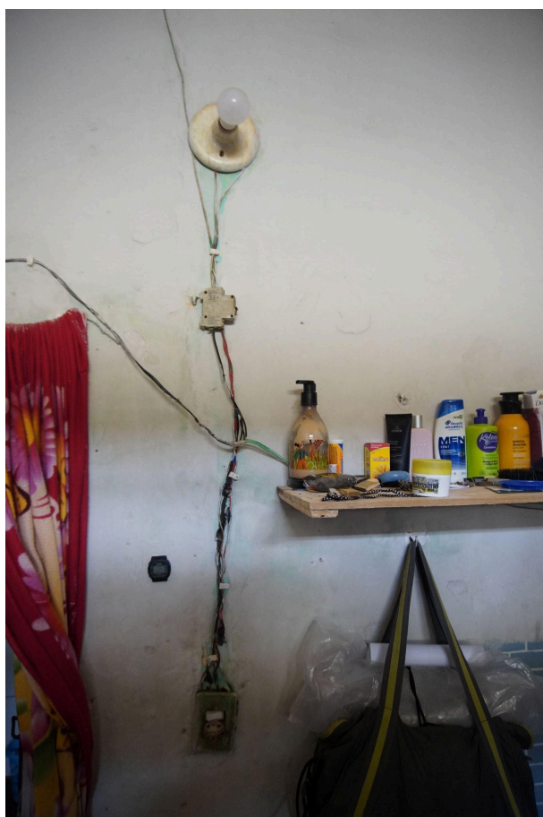
Descrição da imagem: fiação exposta
