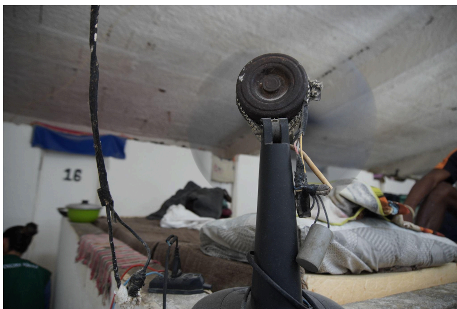
Descrição da imagem: ponto de eletricidade improvisado
