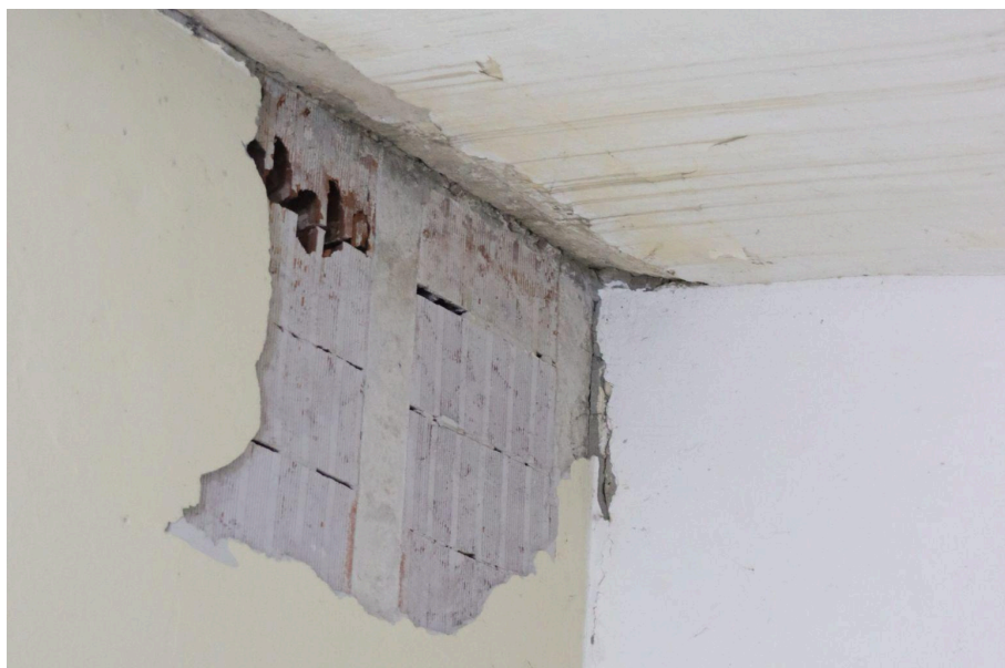
Descrição da imagem: precariedade das instalações
