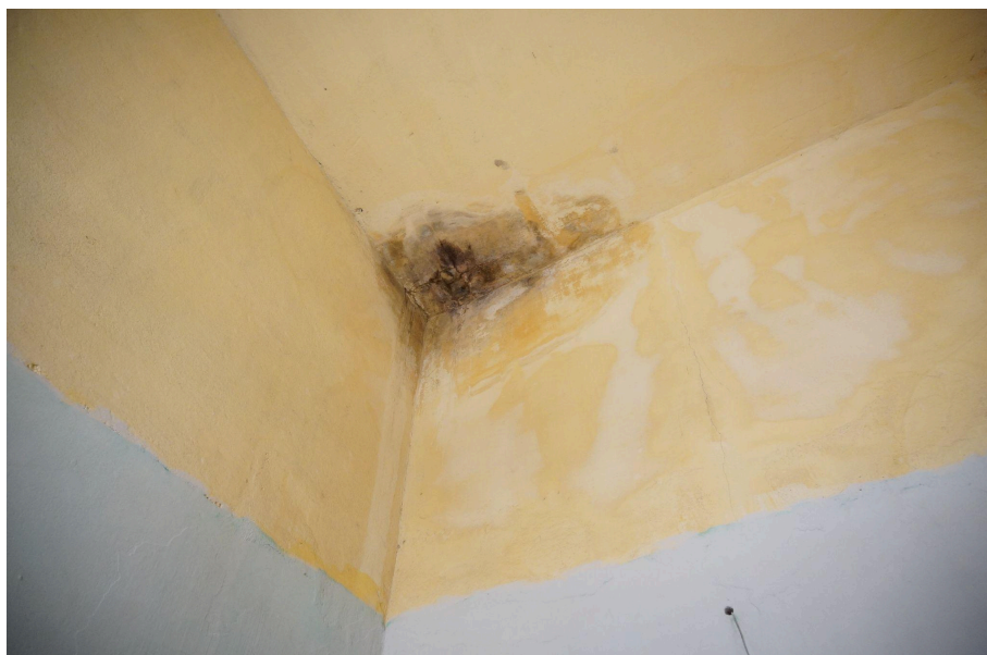
Descrição da imagem: precariedade das instalações
