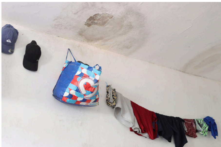
Descrição da imagem: precariedade das instalações
