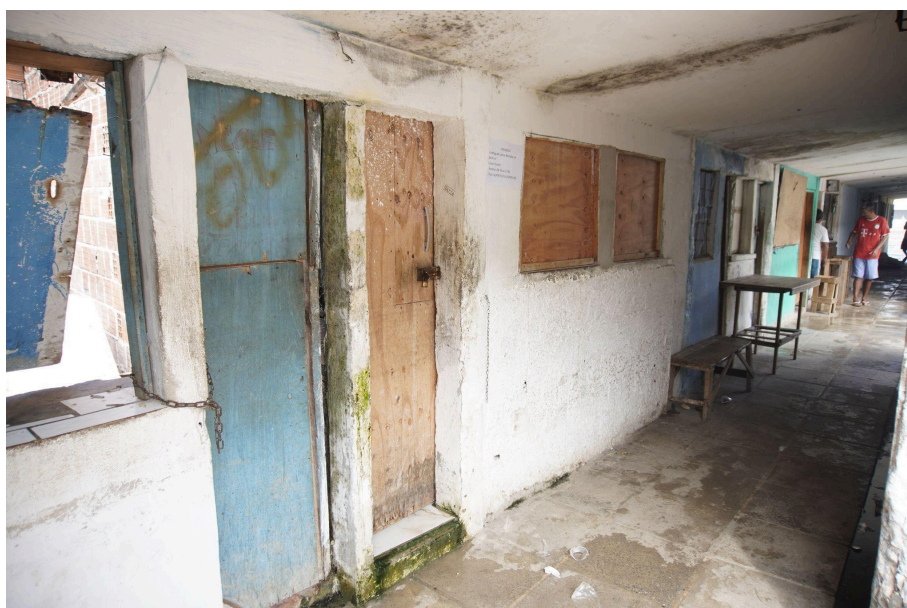
Descrição da imagem: precariedade das instalações
