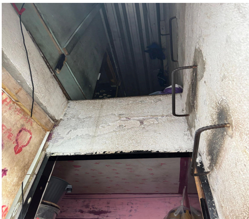
Descrição da imagem: escadas improvisadas
